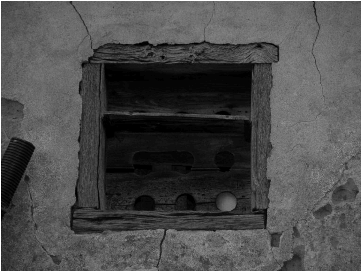
Détail de l'ouverture haute du mur gouttereau sud. Entrée des pigeons.
