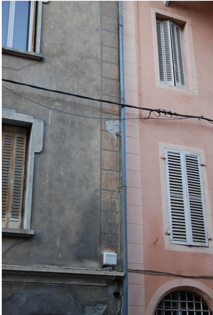
Elévation sur rue, détail des angles peints à la jonction de l'auberge et de la pension de famille.
