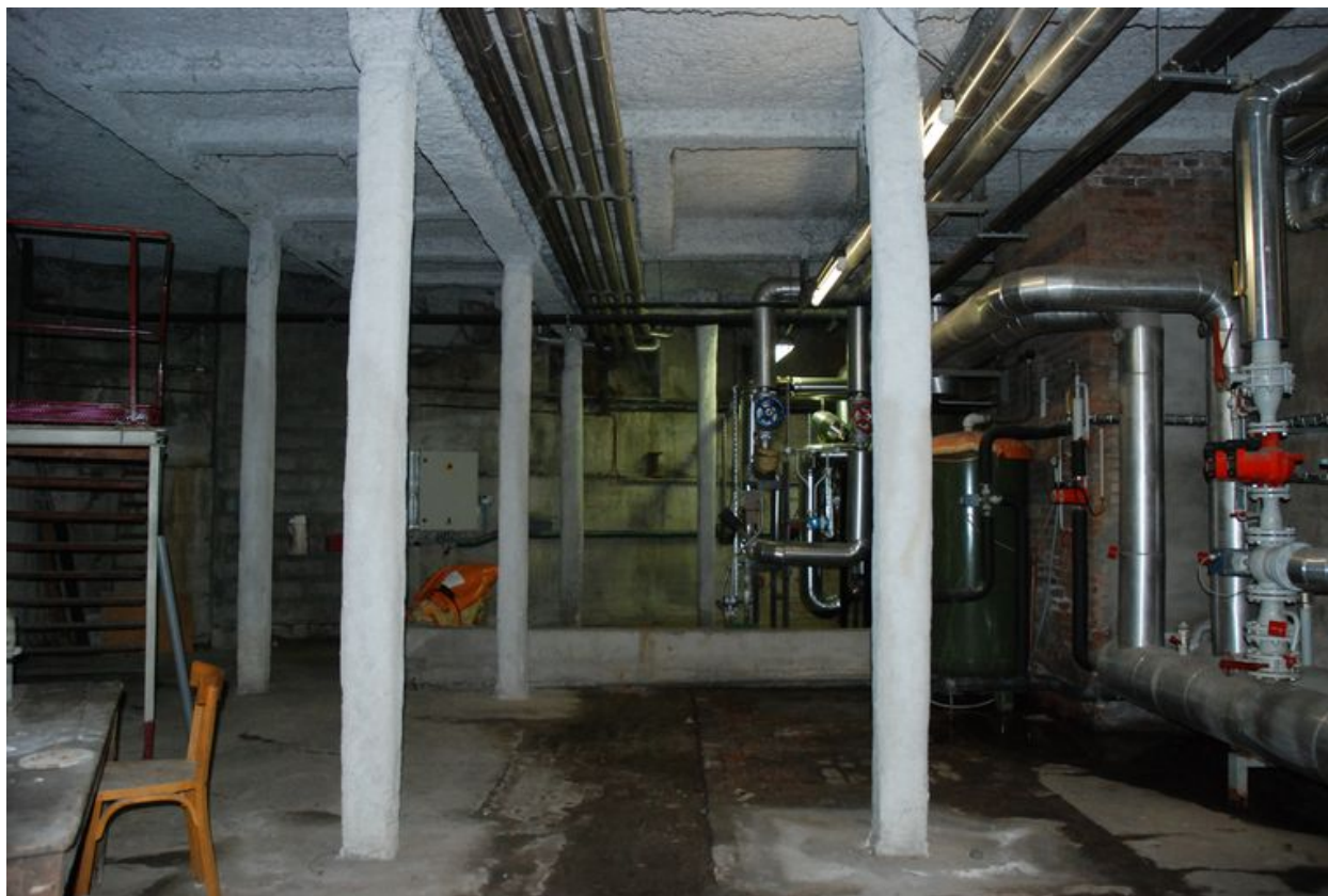
Vue de la chaufferie en sous-sol
