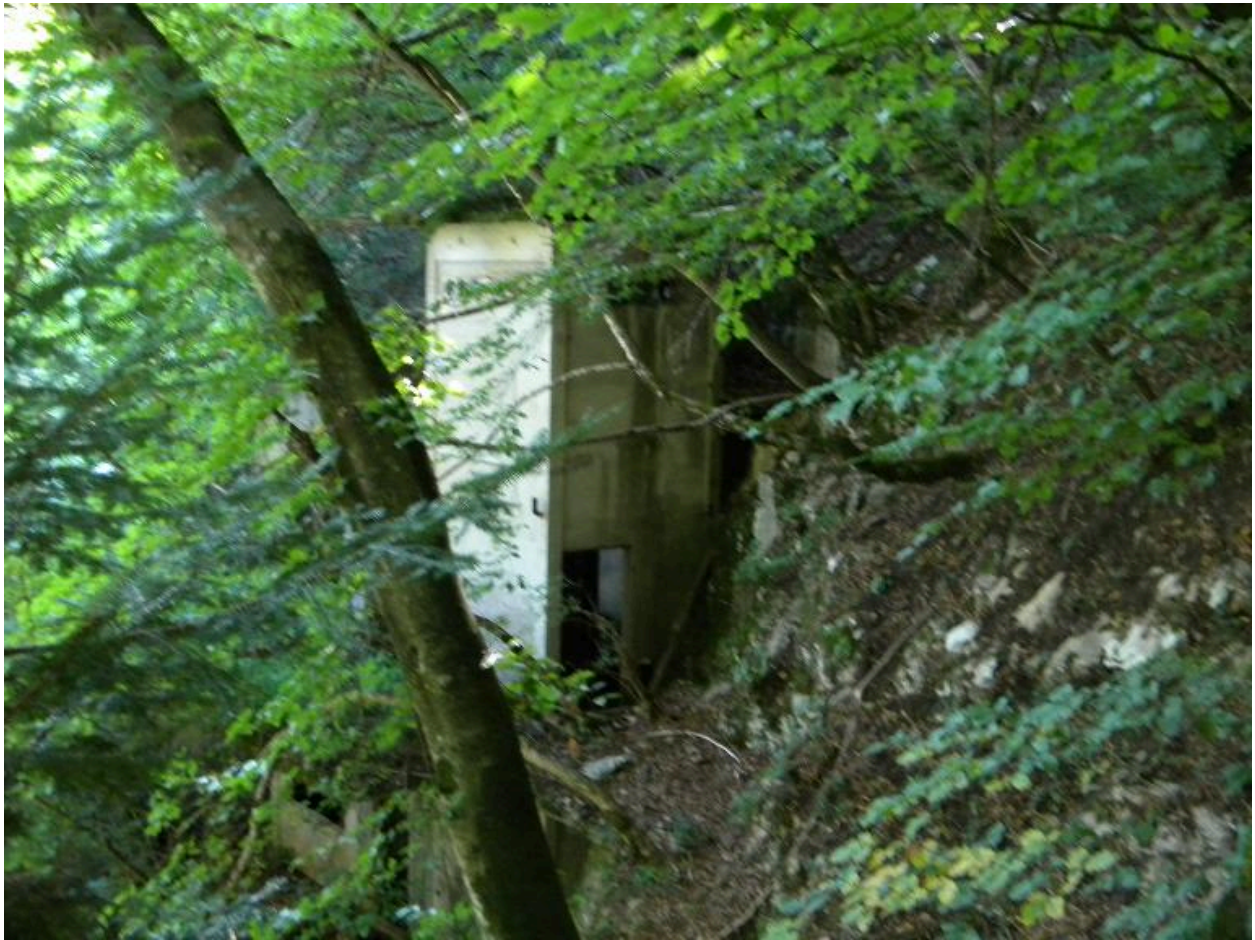
Vue du transformateur électrique dans la pente.
