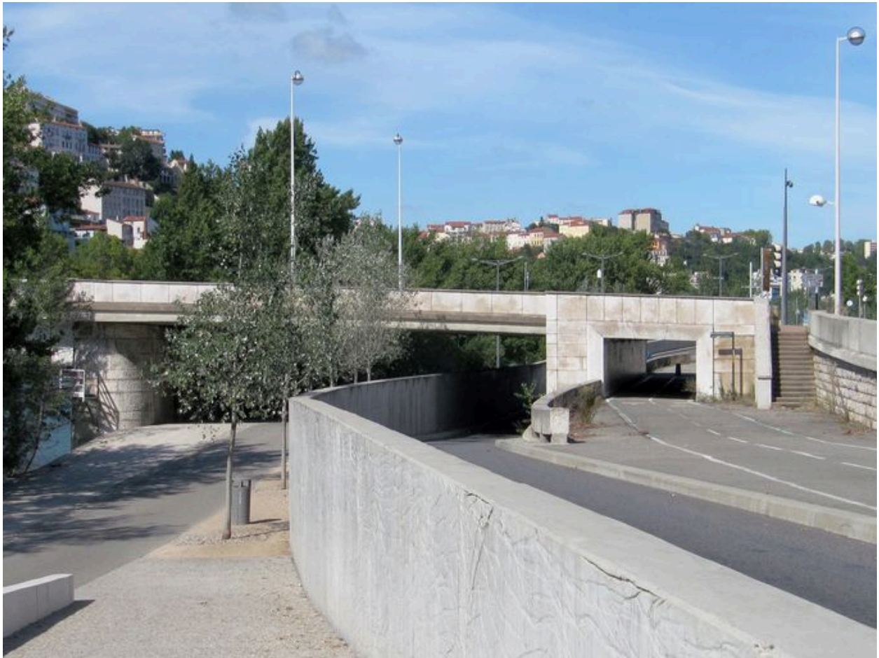
Travée et arche de rive gauche, face aval, vue générale (depuis la rive gauche)
