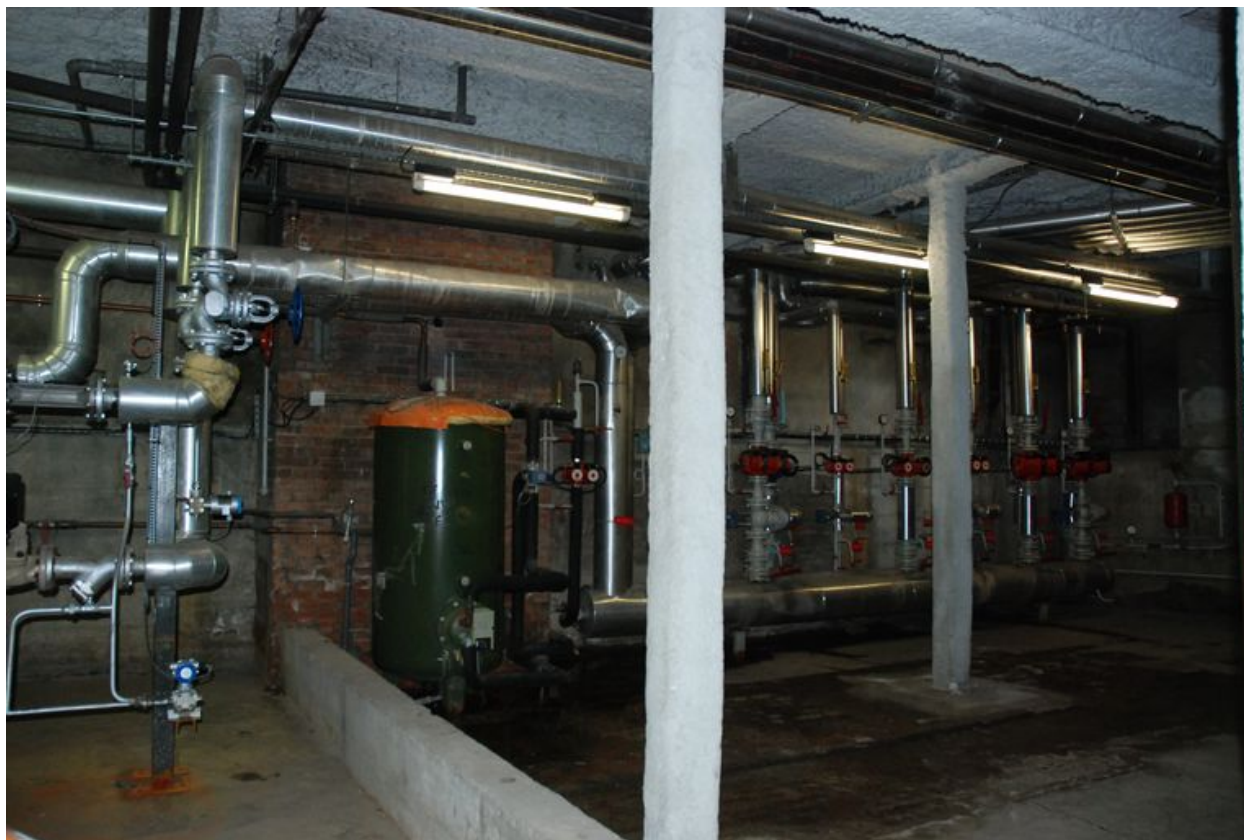
Vue de la chaufferie en sous-sol
