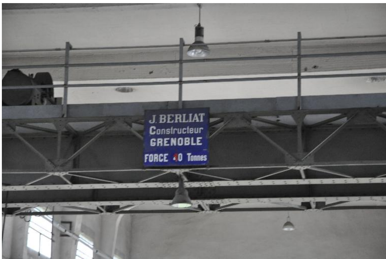
Détail du poids supporté par le pont roulant du second bâtiment des Clavaux
