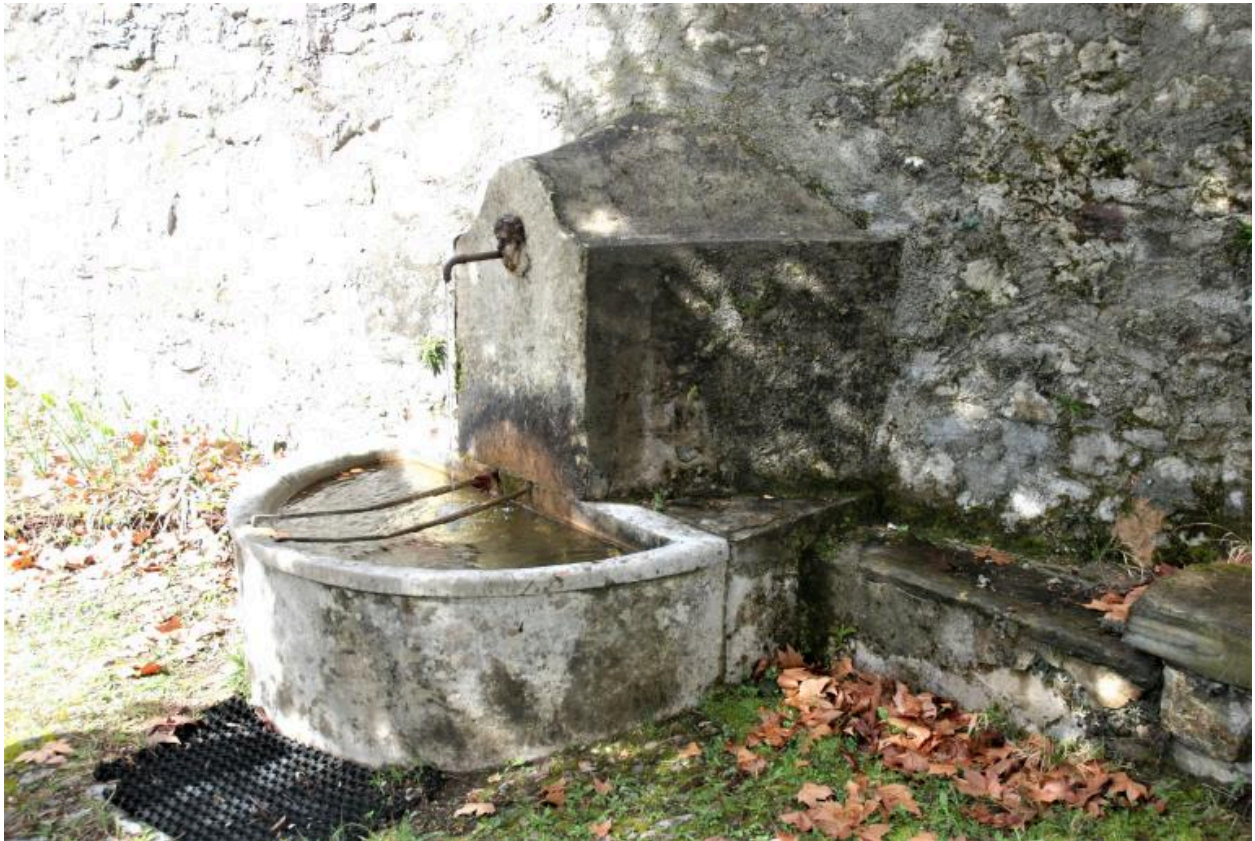
Vue d'ensemble de la fontaine en pierre adossée au mur de clôture nord de la cour.
