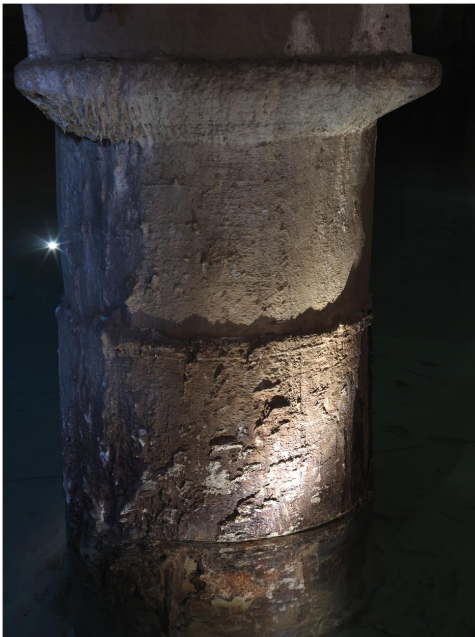
Détail colonne bassins filtrants
