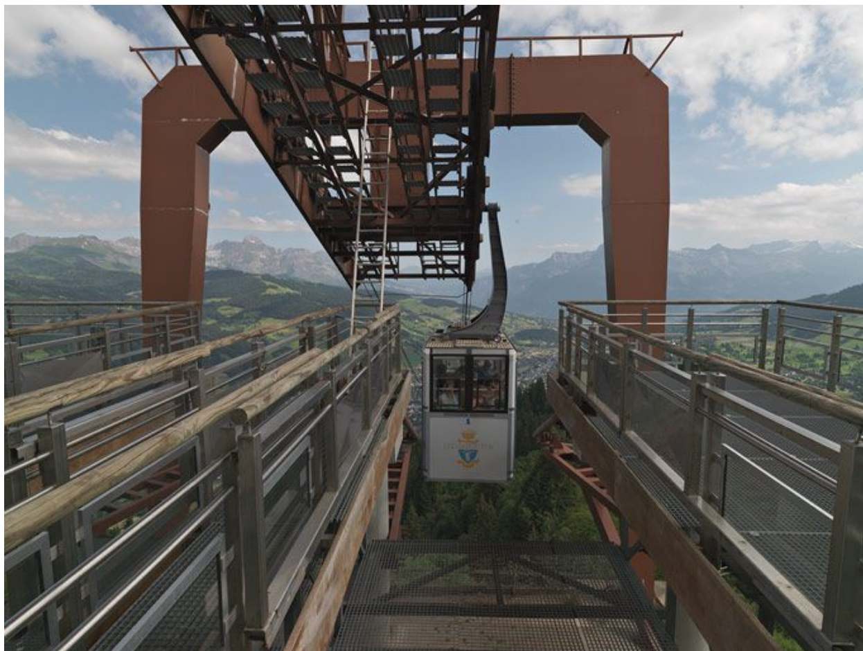
Gare supérieure. Portique et rails de portage des câbles. Arrivée de la cabine
