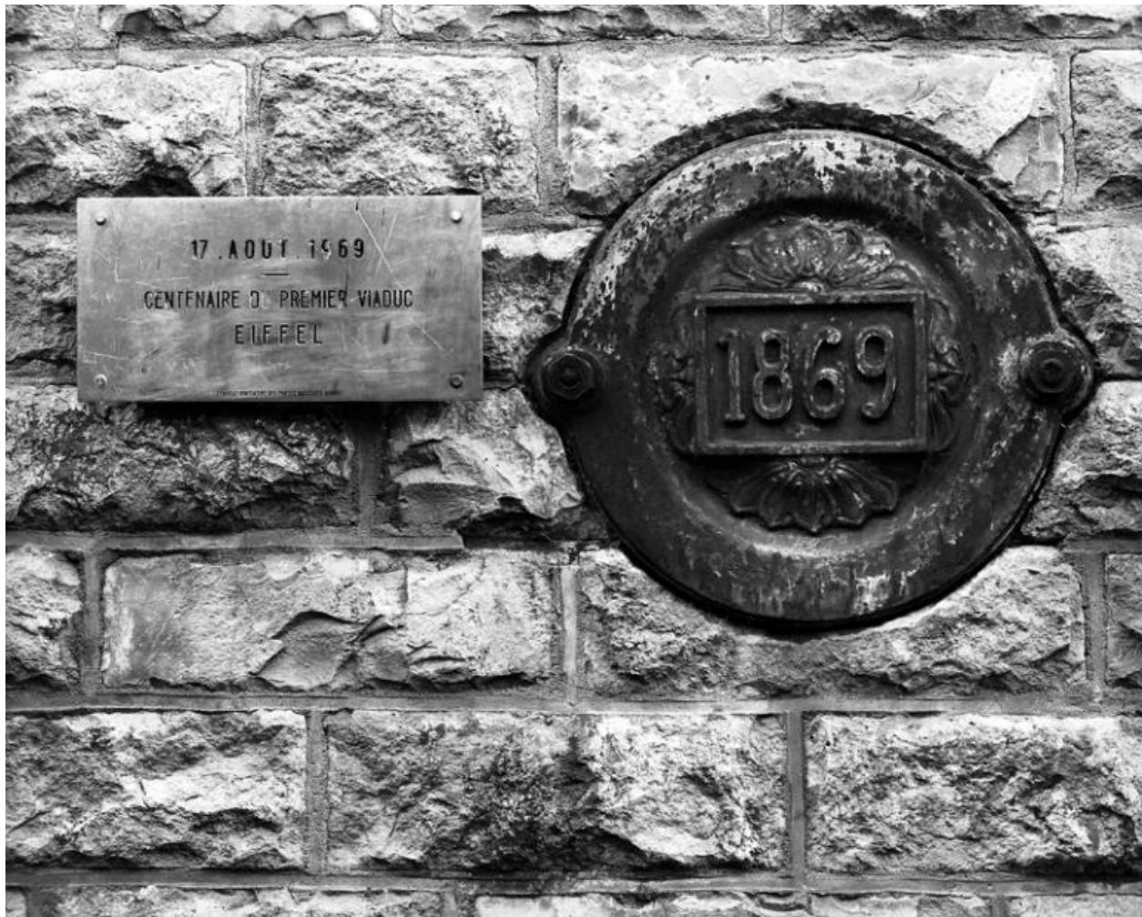
Détail de la plaque portant la date de construction (1869) et de la plaque du centenaire apposée à côté.
