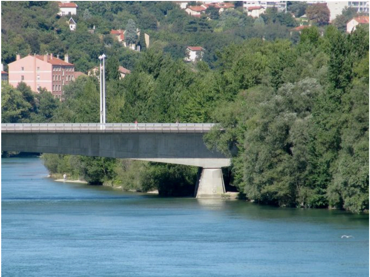
Vue partielle, pile, face aval (depuis le pont de Lattre de Tassigny)
