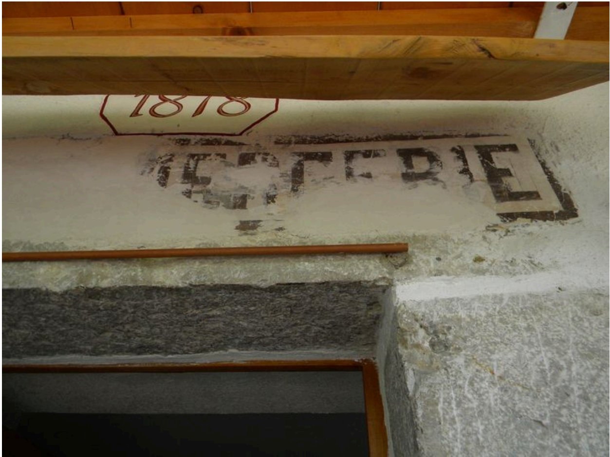
Ancienne enseigne peinte de la mercerie sur le linteau de la porte d'entrée.
