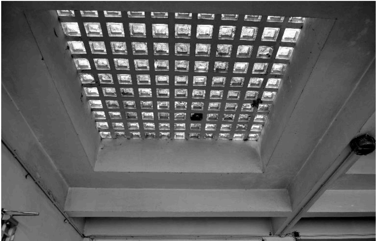
Préau joignant le bâtiment F à l'infirmerie, détail de la couverture en béton et briques de verre
