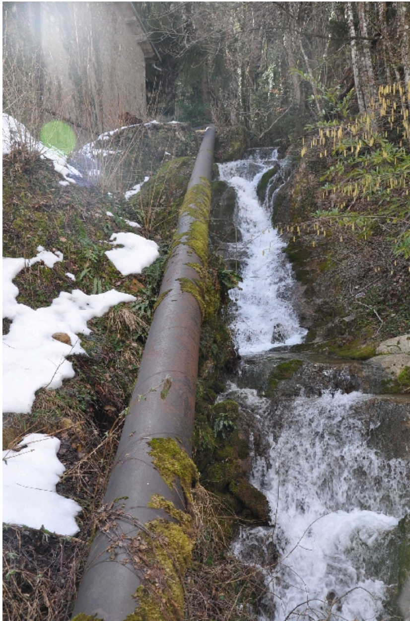
Vue de la conduite forcée
