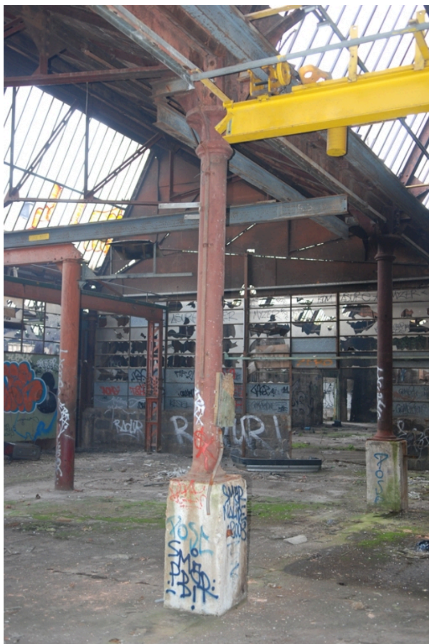
Poteau fonte avec surélévation en béton
