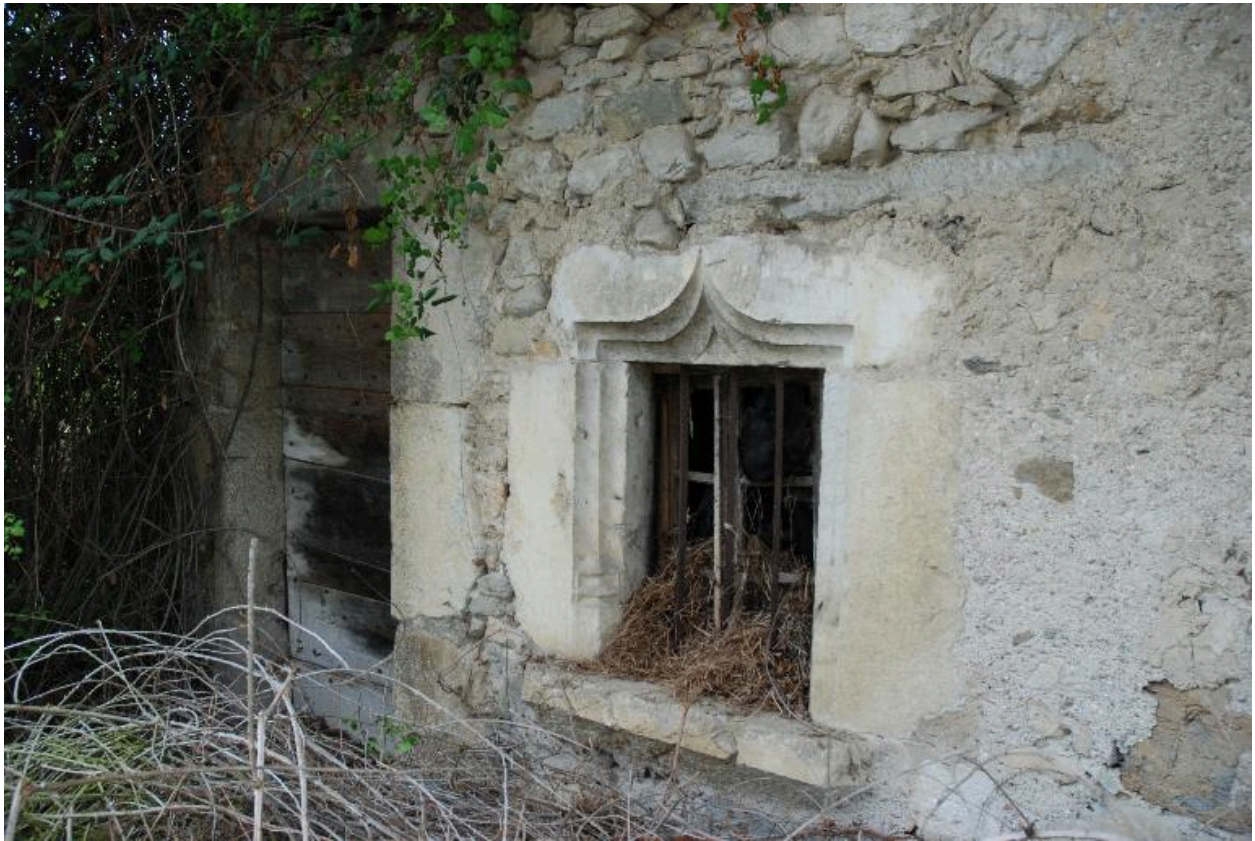
Détail des ouvertures du logis.
