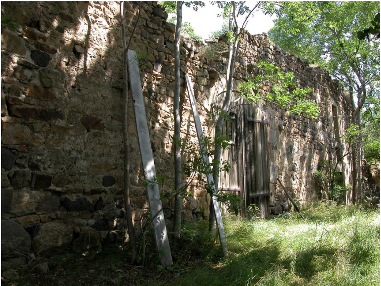
Bâtiments agricoles en ruine : grange (1986 AL 220).
