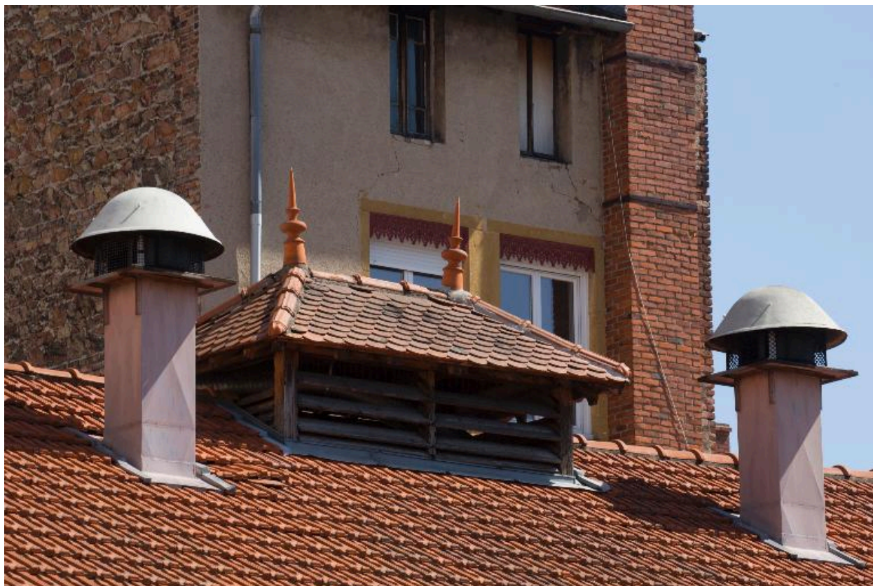
Bâtiment G, annexe sud. Aérations sur le toit
