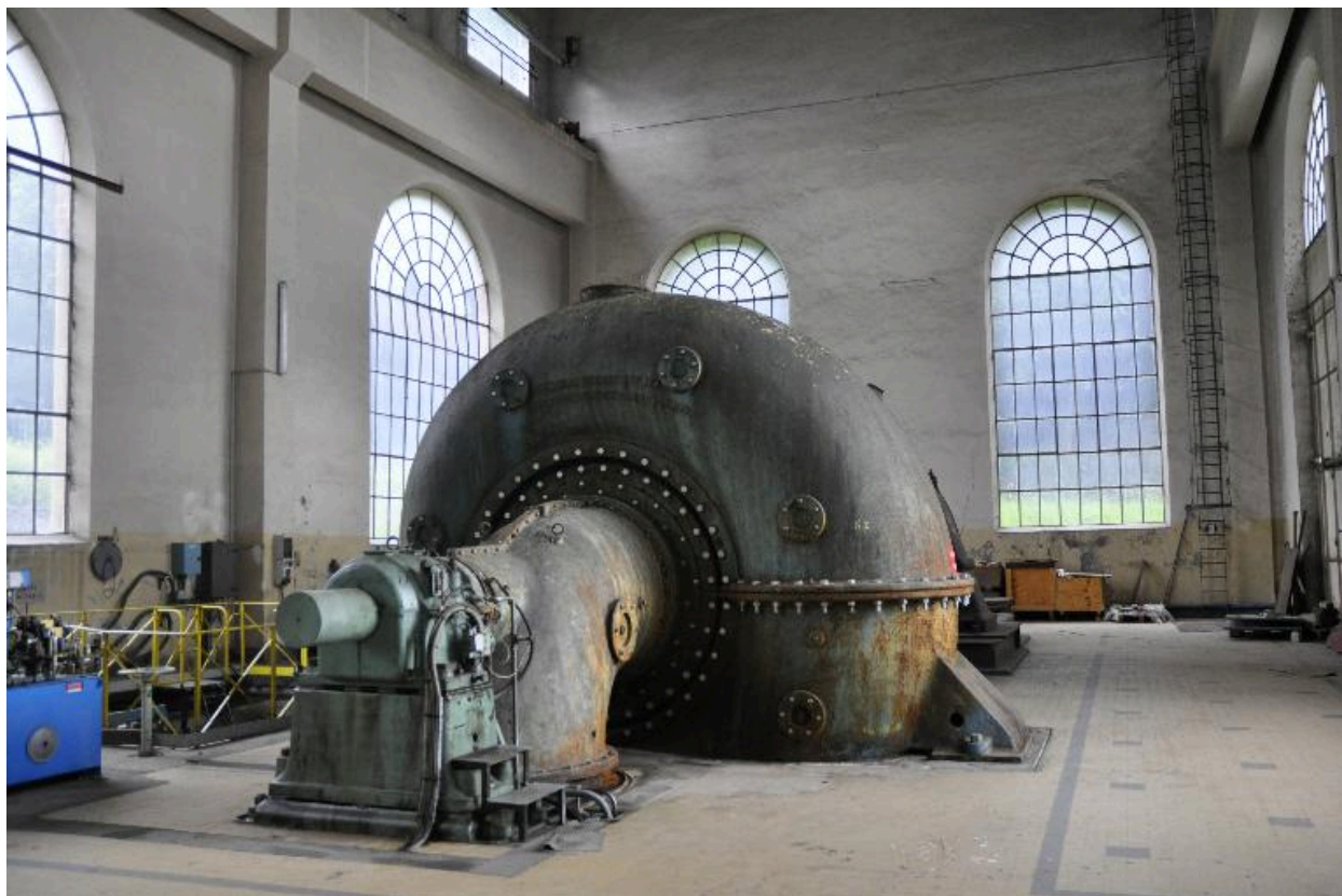
Vue d'un groupe horizontal
