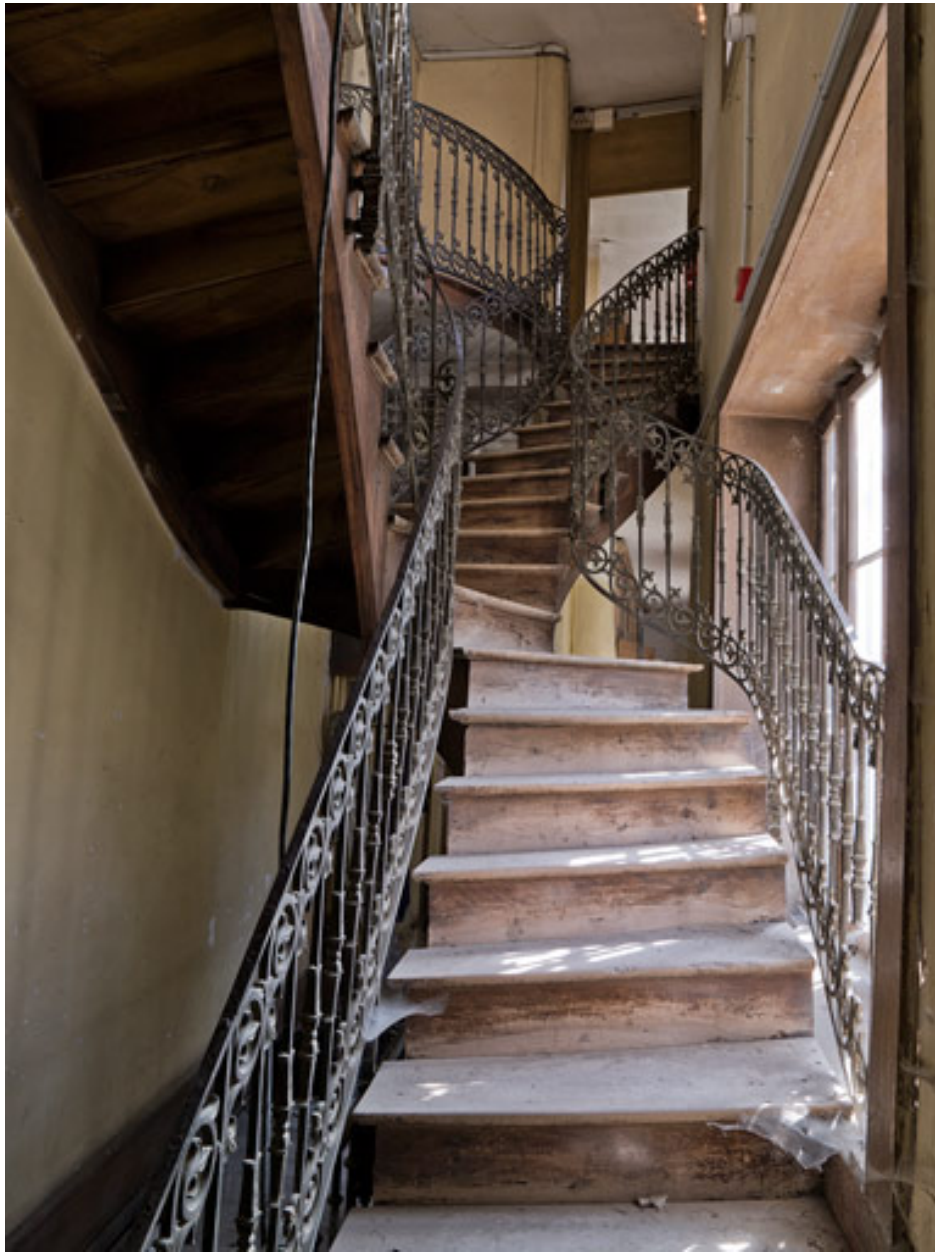
Escalier intérieur, 1ère volée droite et 2e volée double à montées divergentes.
