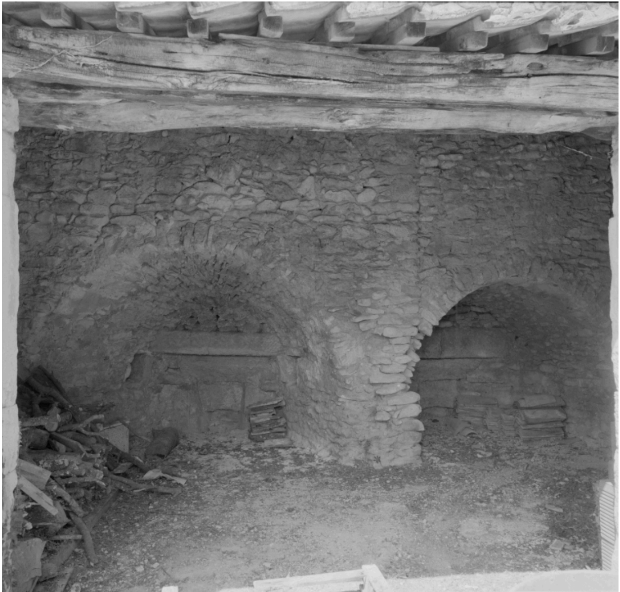
Vue intérieure du four à chaux double.
