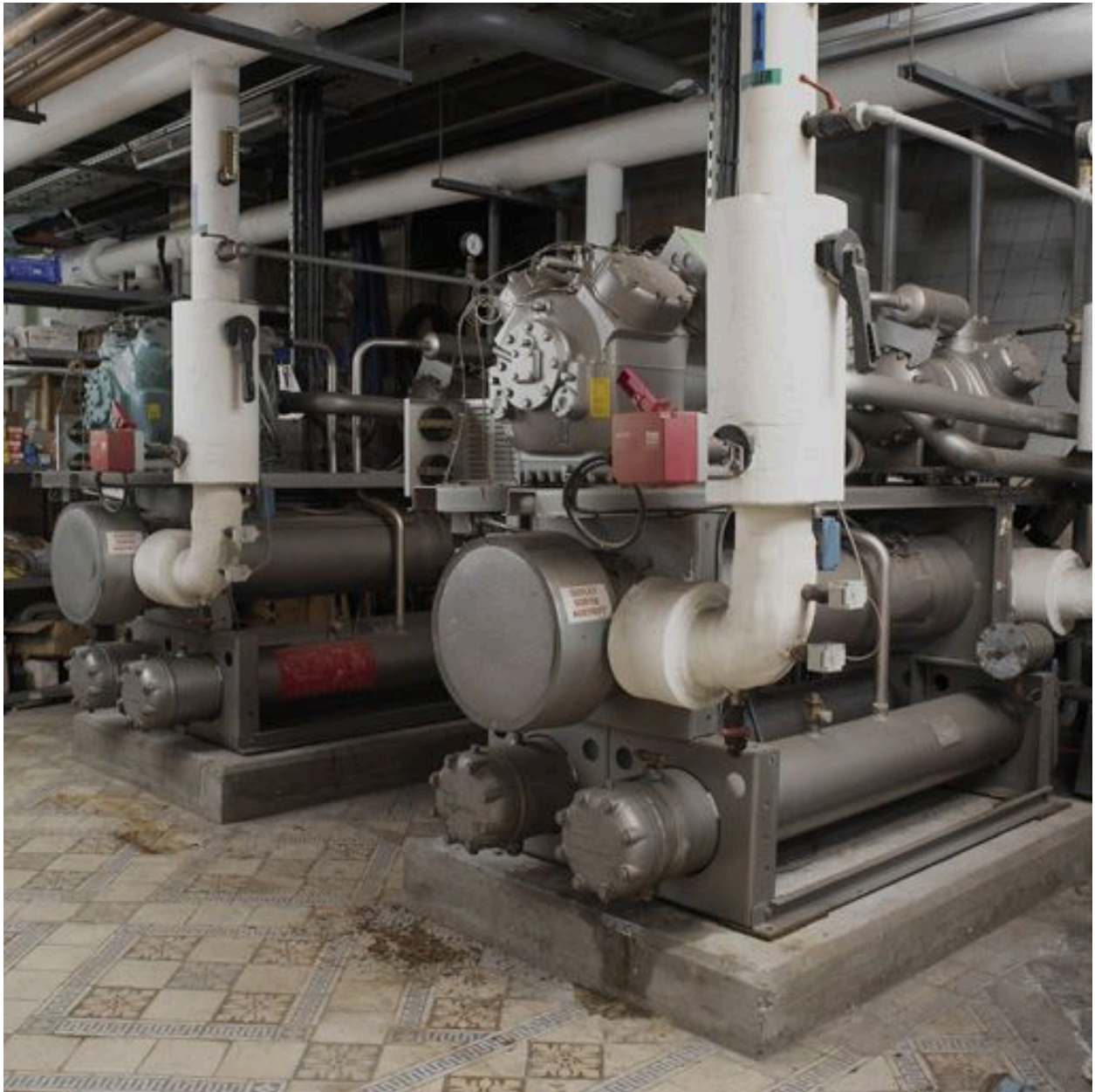
Sous-sol rue de la République, salle des machines : les climatiseurs compresseurs
