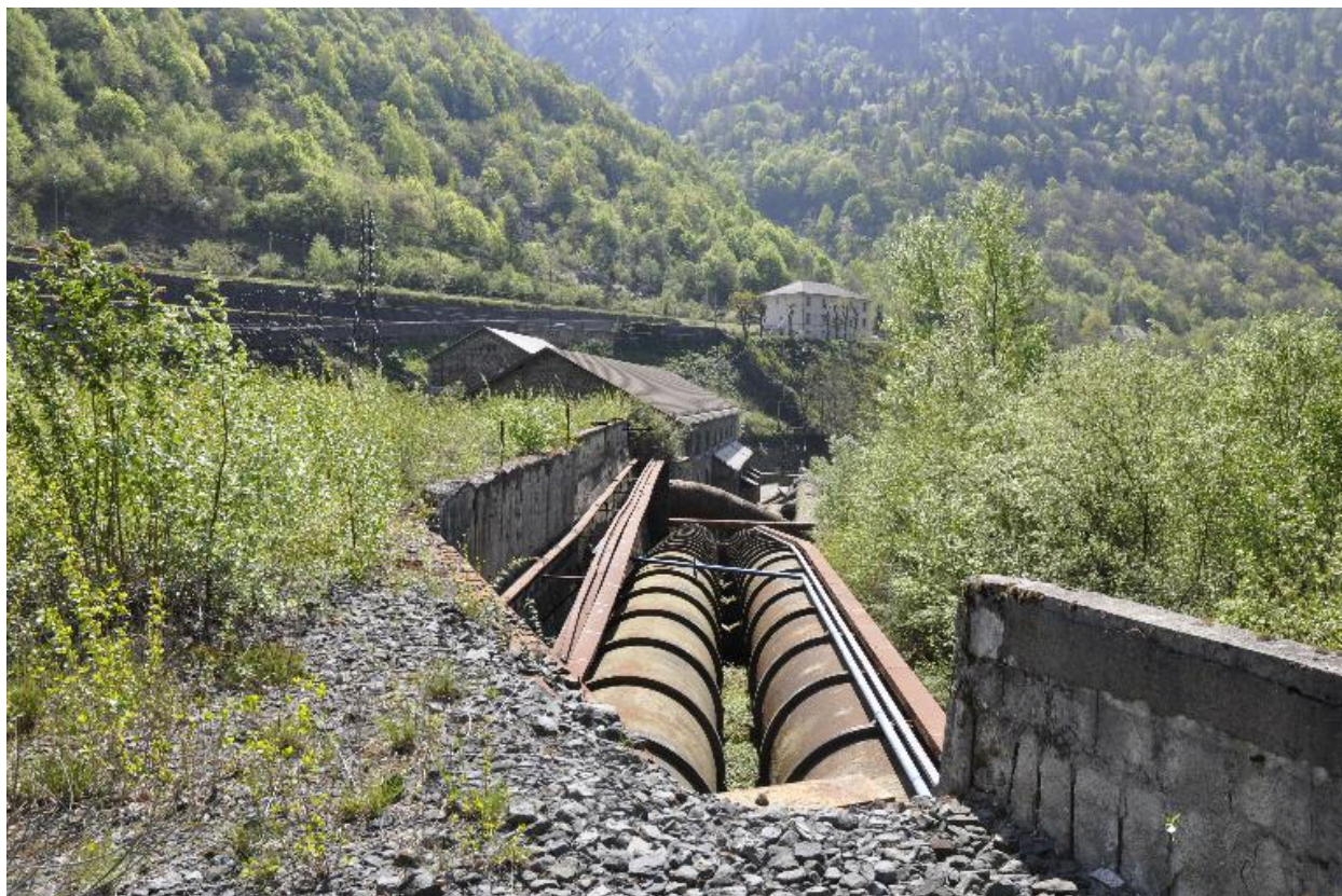
Vue des conduites forcées et de la centrale
