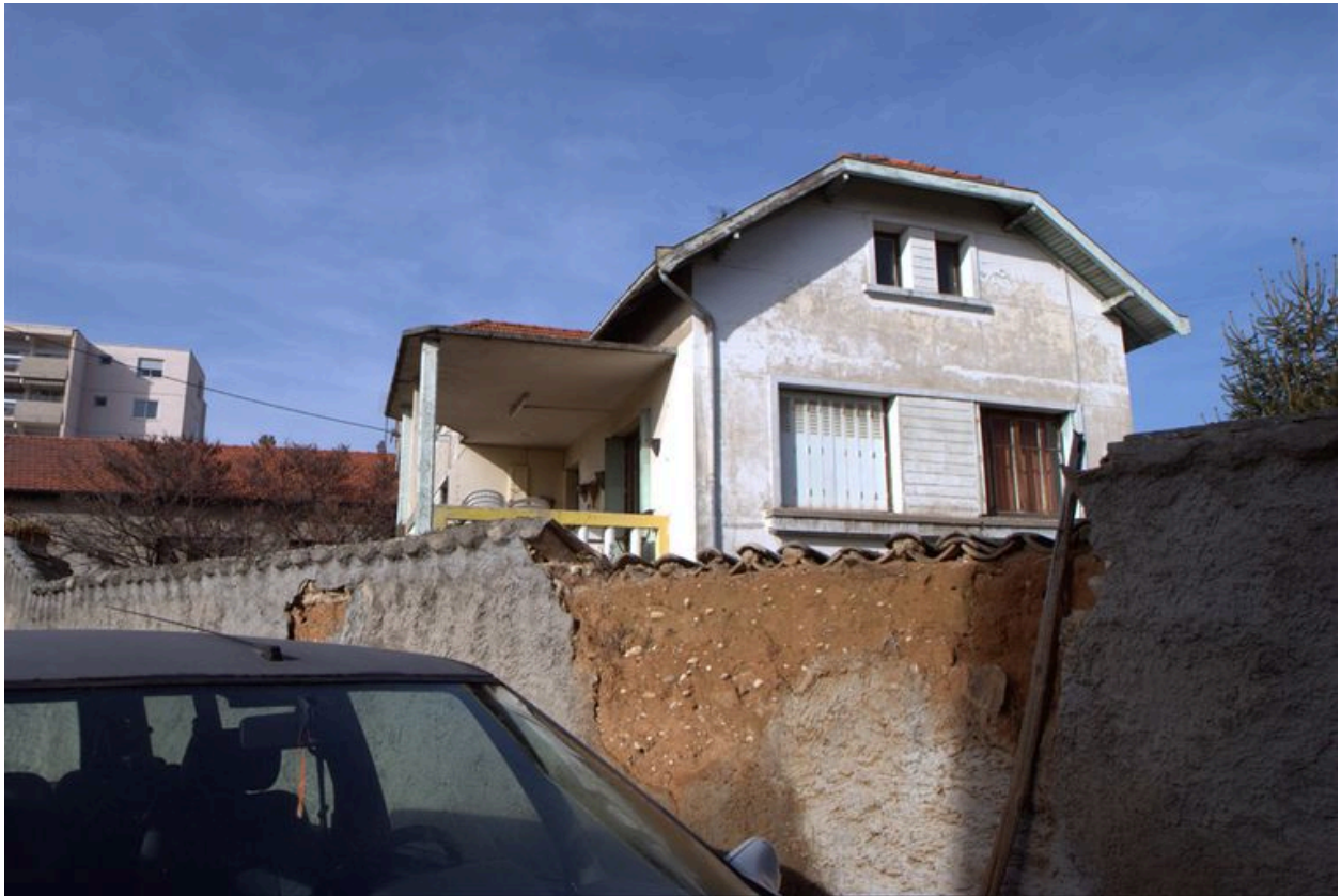
Elévation latérale du 73bis rue des Puiseurs et détail du mur en pisé
