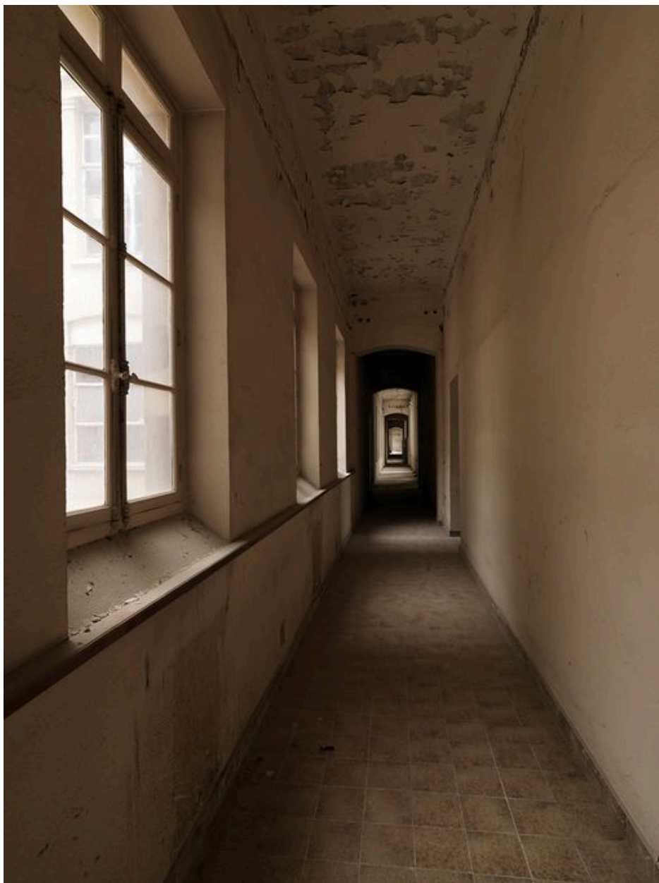
Vue de la galerie de circulation est-ouest durant les travaux de mai 2011.
