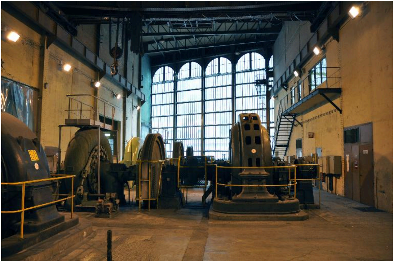
Vue de la salle des machines de la centrale de Livet
