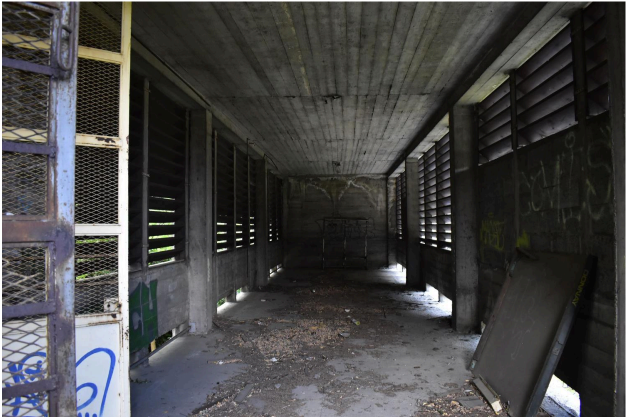
Intérieur du séchoir à bois. [Photo chercheure.]
