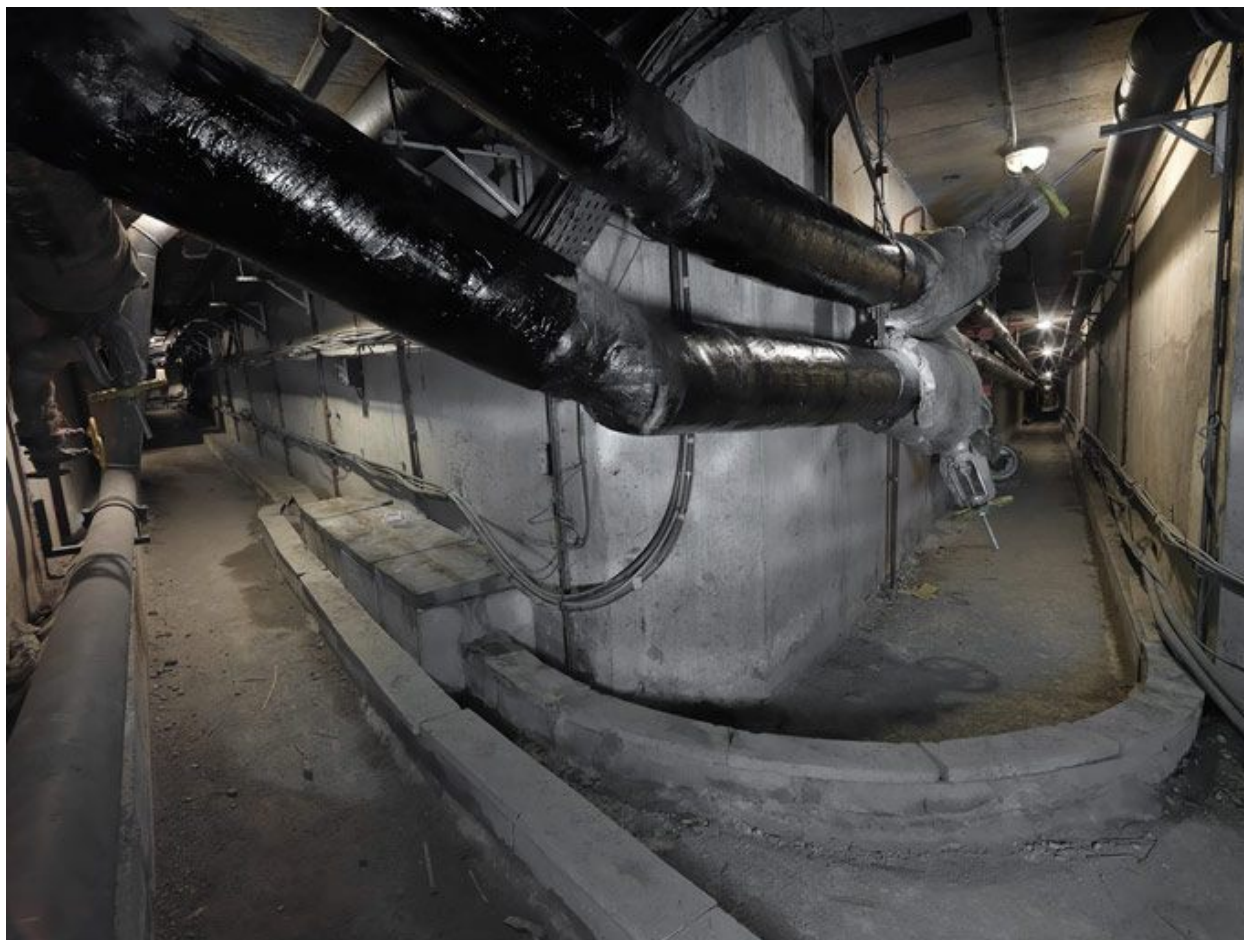
Les galeries au carrefour entre les sous-stations Aldébaran et Totem
