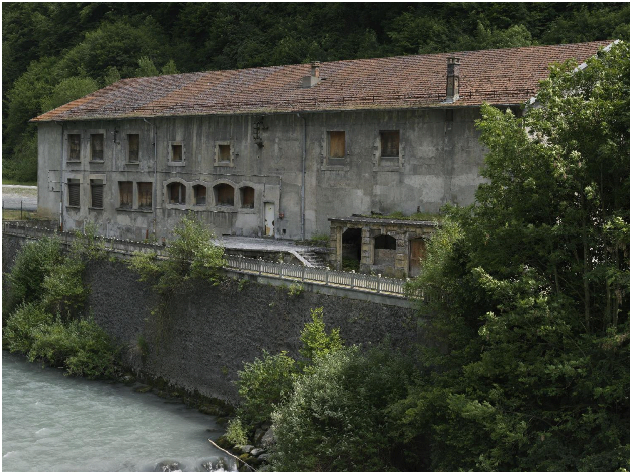
Façade côté Romanche.
