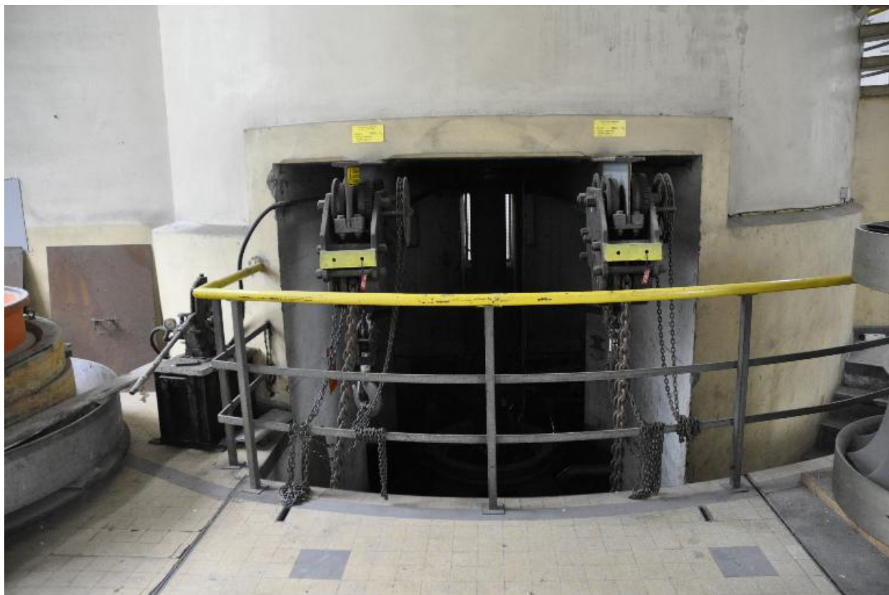
Fosse vannage du G3
