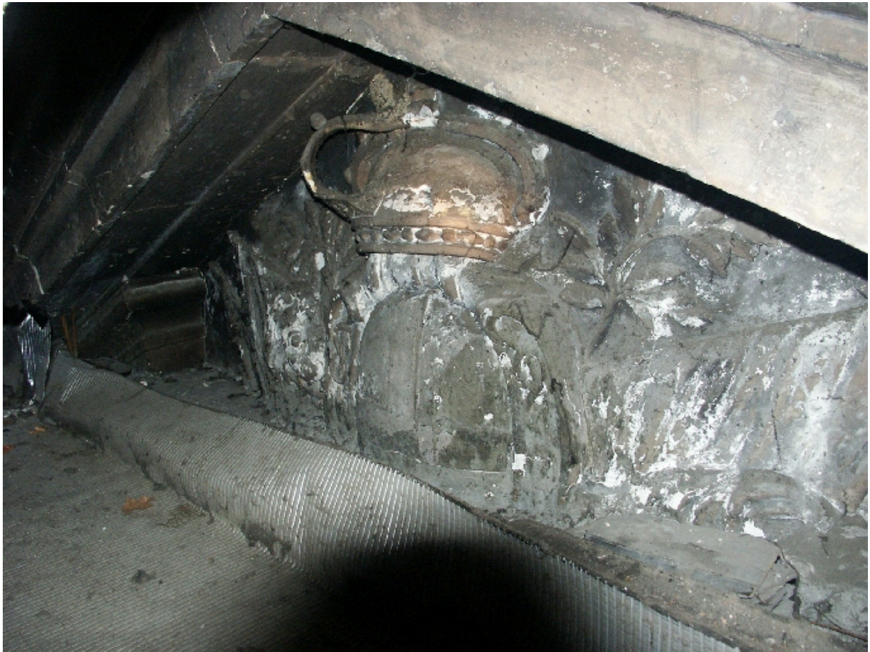
Fronton avant restauration
