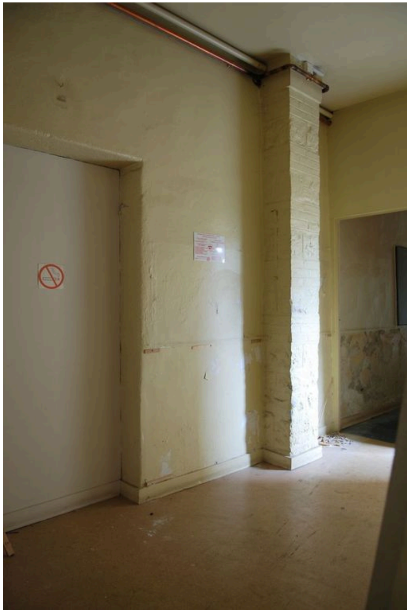
Pilier du promenoir transformé en salle fermée, à la jonction du bâtiment et de l'ancien promenoir
