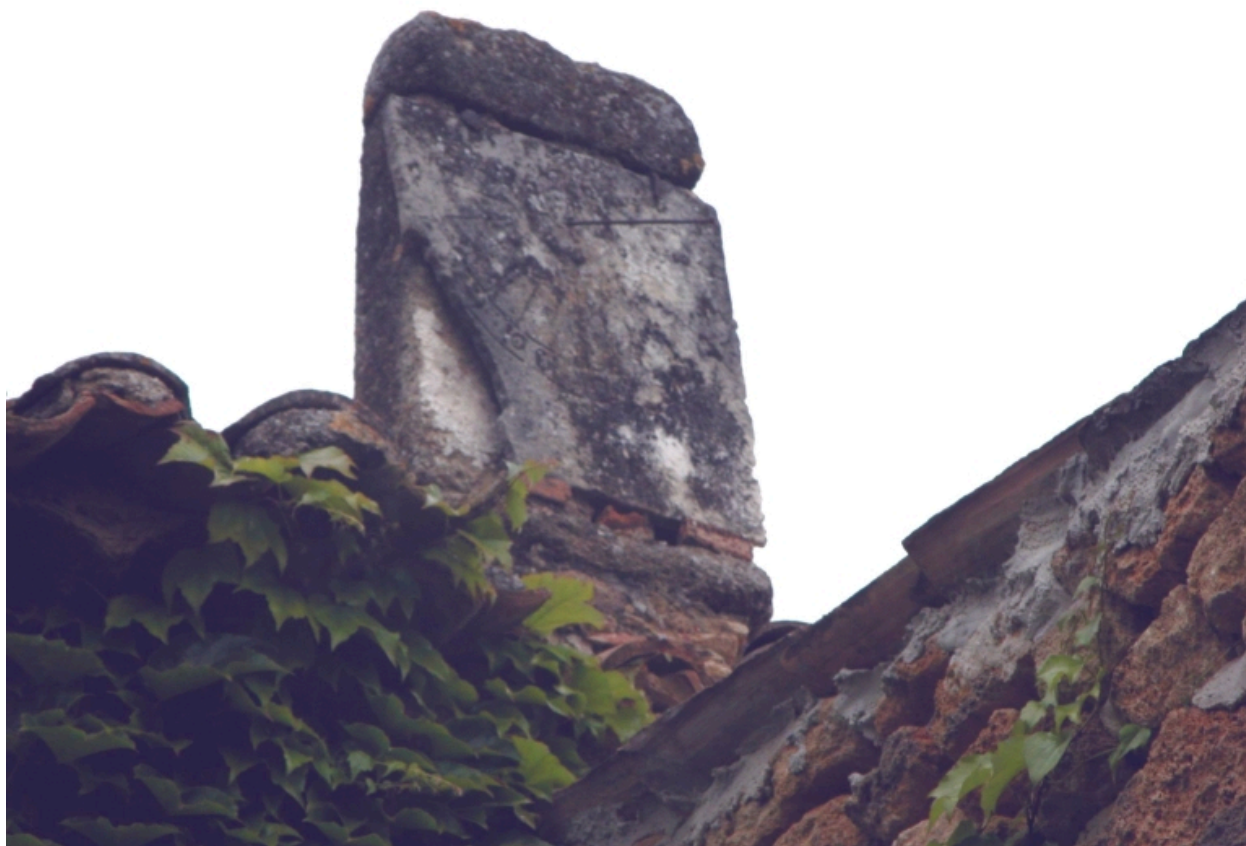
Le cadran solaire, situé au-dessus du troisième logis, à l'extrémité du toit.
