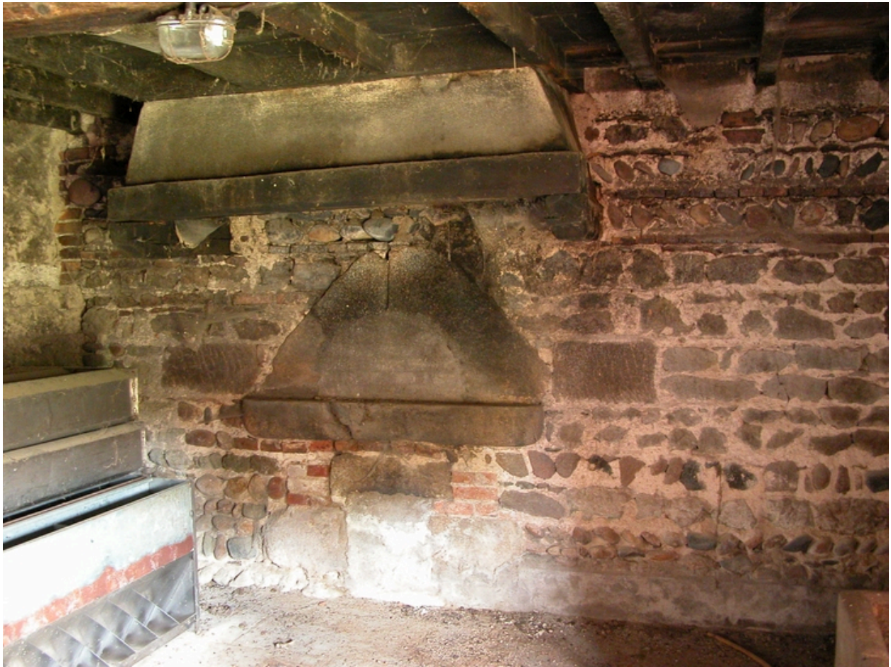
Vue intérieure du fournil.
