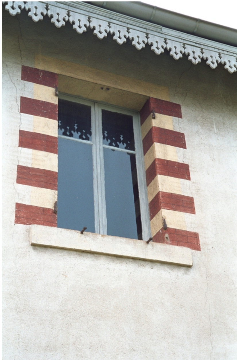
Elévation partielle de la façade sur jardin, côté droit, détail de baie à faux encadrement.
