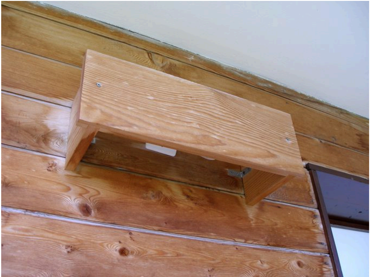
Un luminaire de coursière
