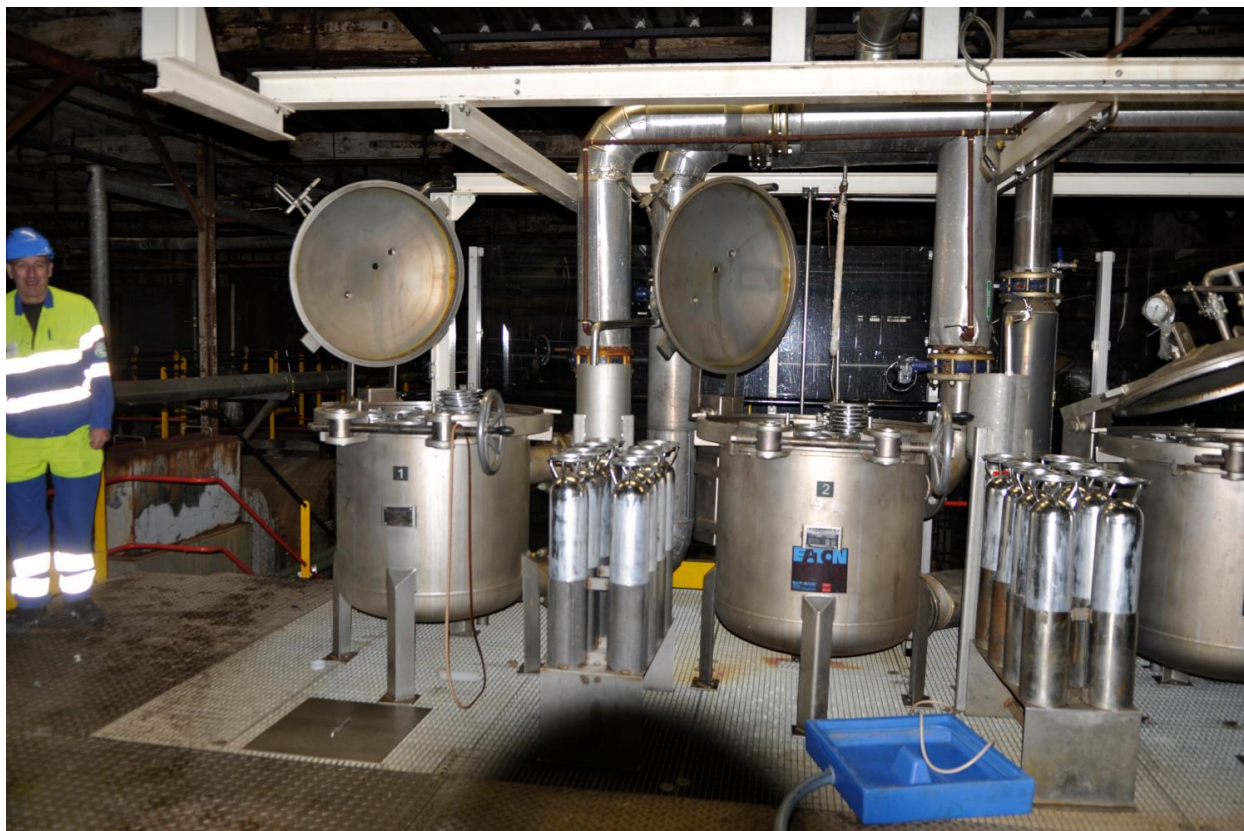
Echangeur de chaleur
