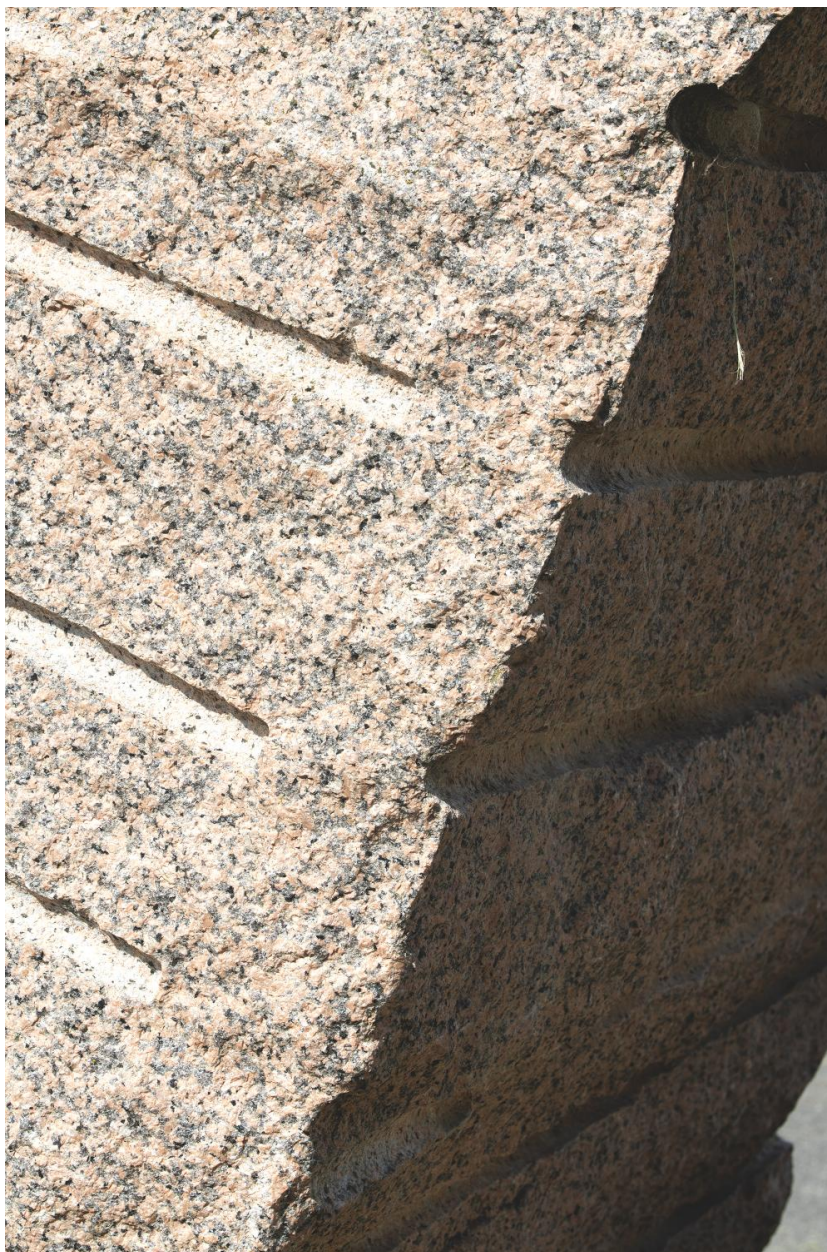
Epaufures dans un angle du cube
