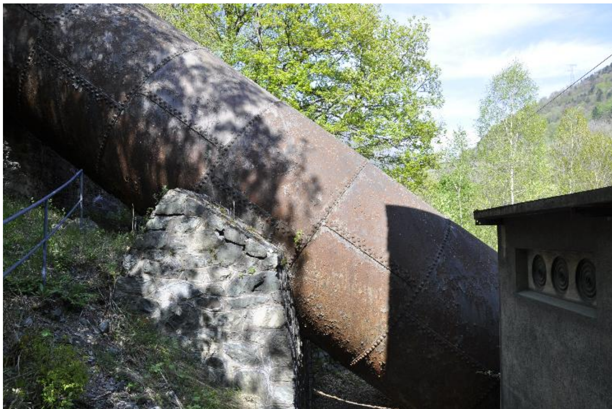
Vue d'une conduite forcée extérieure "venant de la montagne"
