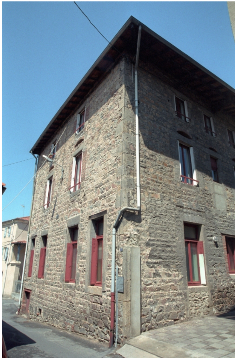
Boën, îlot 19, Alsace Lorraine (rue) 4. Vue générale de la façade sur rue.
