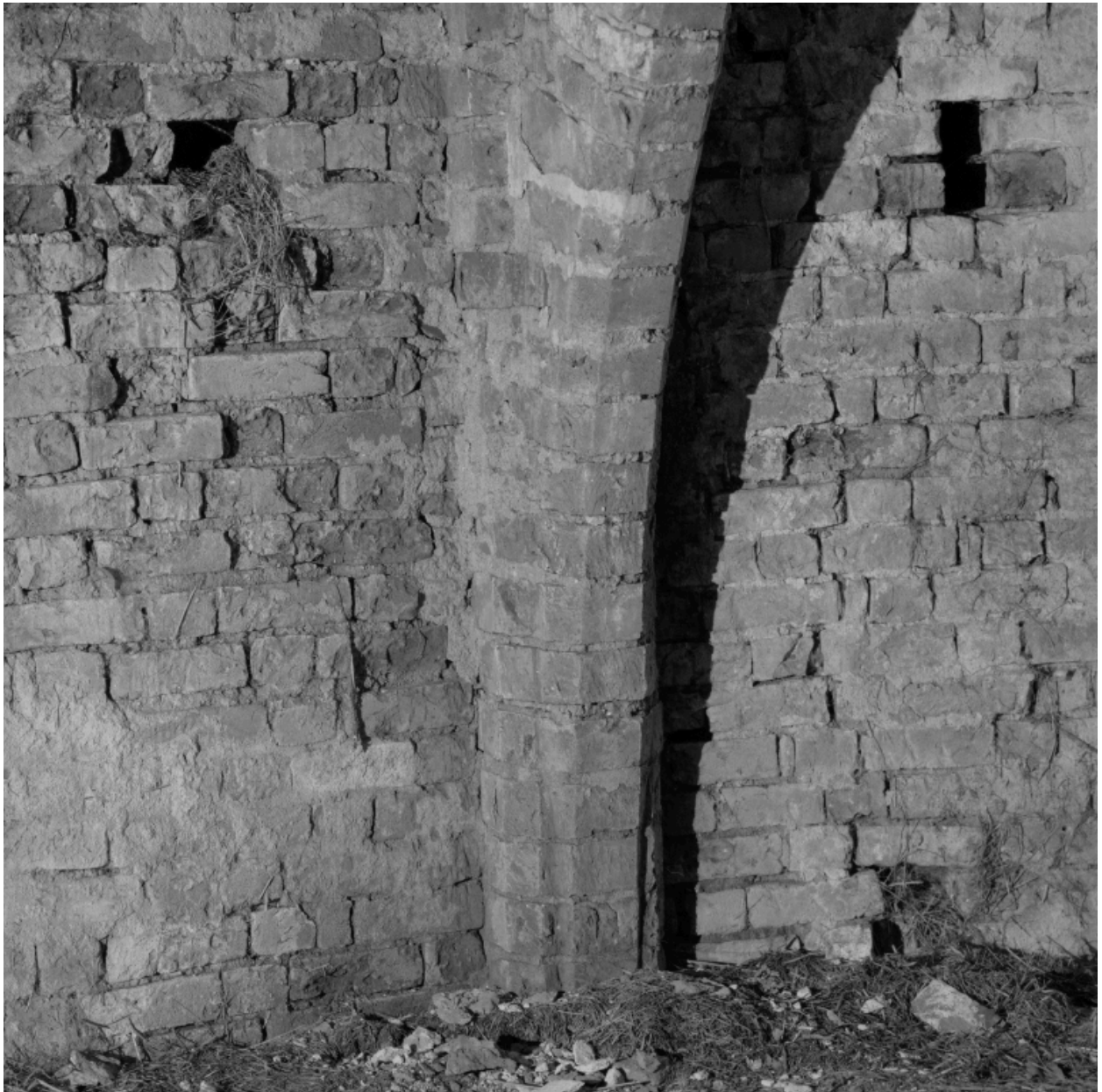
Détail de mise en oeuvre des briques dans une nervure soutenant la voûte du choeur.
