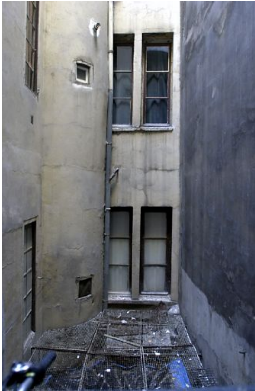
Corps au fond de la 2e cour, élévation des 2e et 3e niveaux
