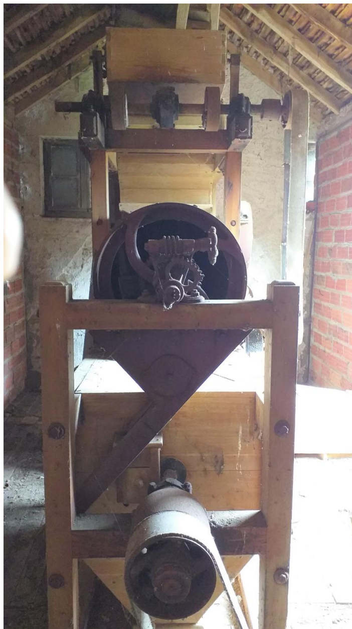
moulin 2, 1er étage : détail du trieur à tambour métallique de la machine à épurer mécaniquement portant le nom du fabricant : "Teisset-Rose-Brault / ingénieurs-constructeurs / Poissy-Paris-Chartres". 1ère moitié du 20e siècle.
