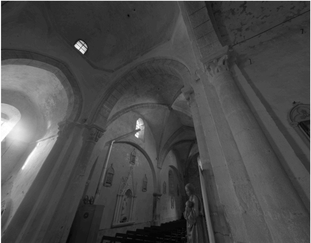
Vue intérieure de la croisée : coupole et départ des voûtes de la nef.
