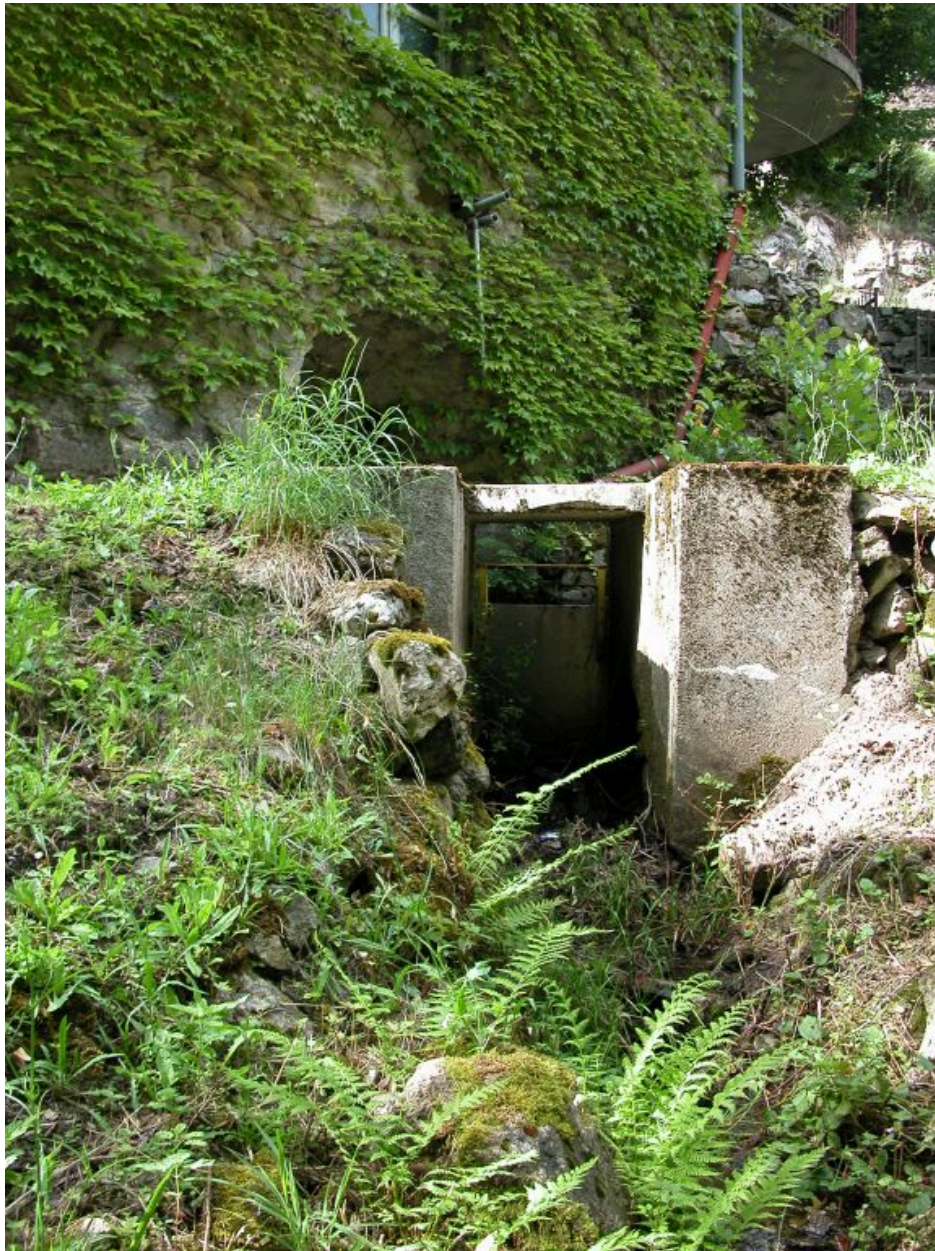
Vanne de décharge à la suite du canal de fuite.
