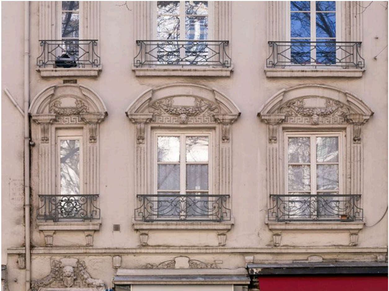
Vue des fenêtres en remploi au 1er étage, partie droite de l'immeuble
