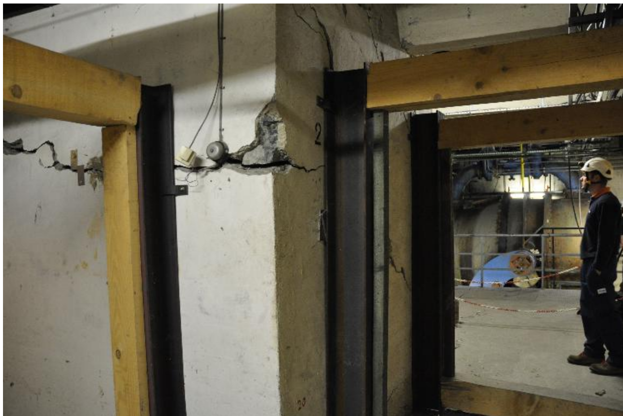
Vue d'une fissure et des étaielements au sous-sol
