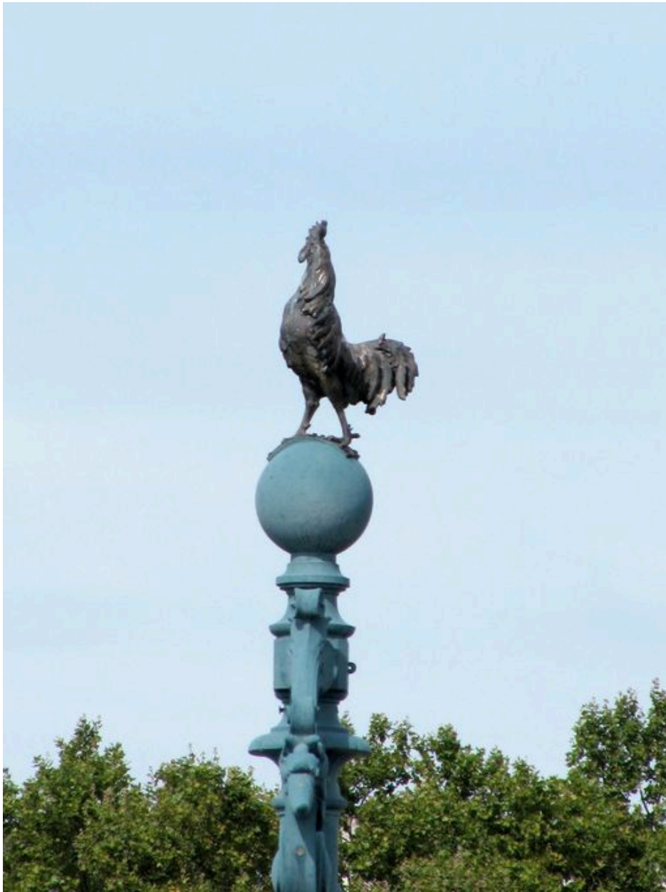
Pile, vue de détail : sommet du décor au-dessus du tablier, coq (depuis la chaussée)
