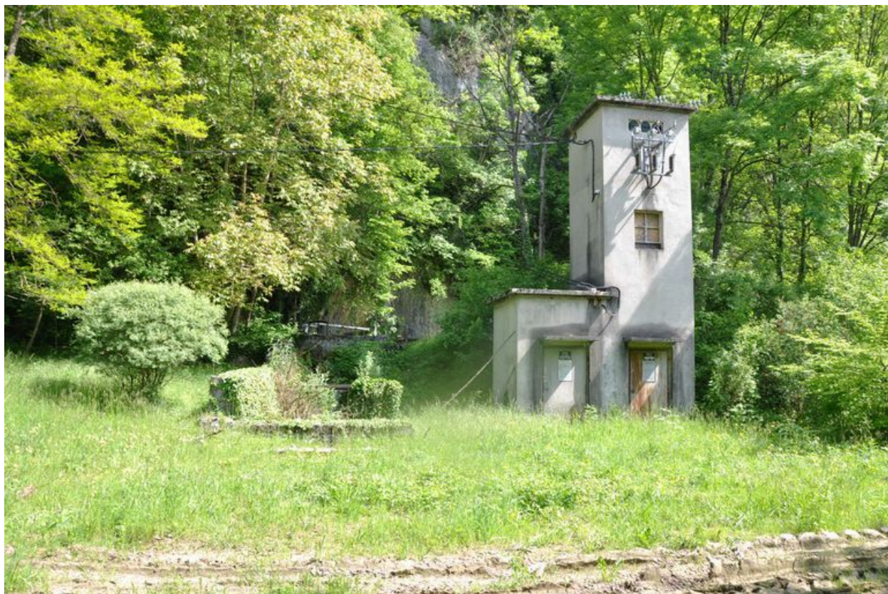
Transformateur de la concession Bourbonge
